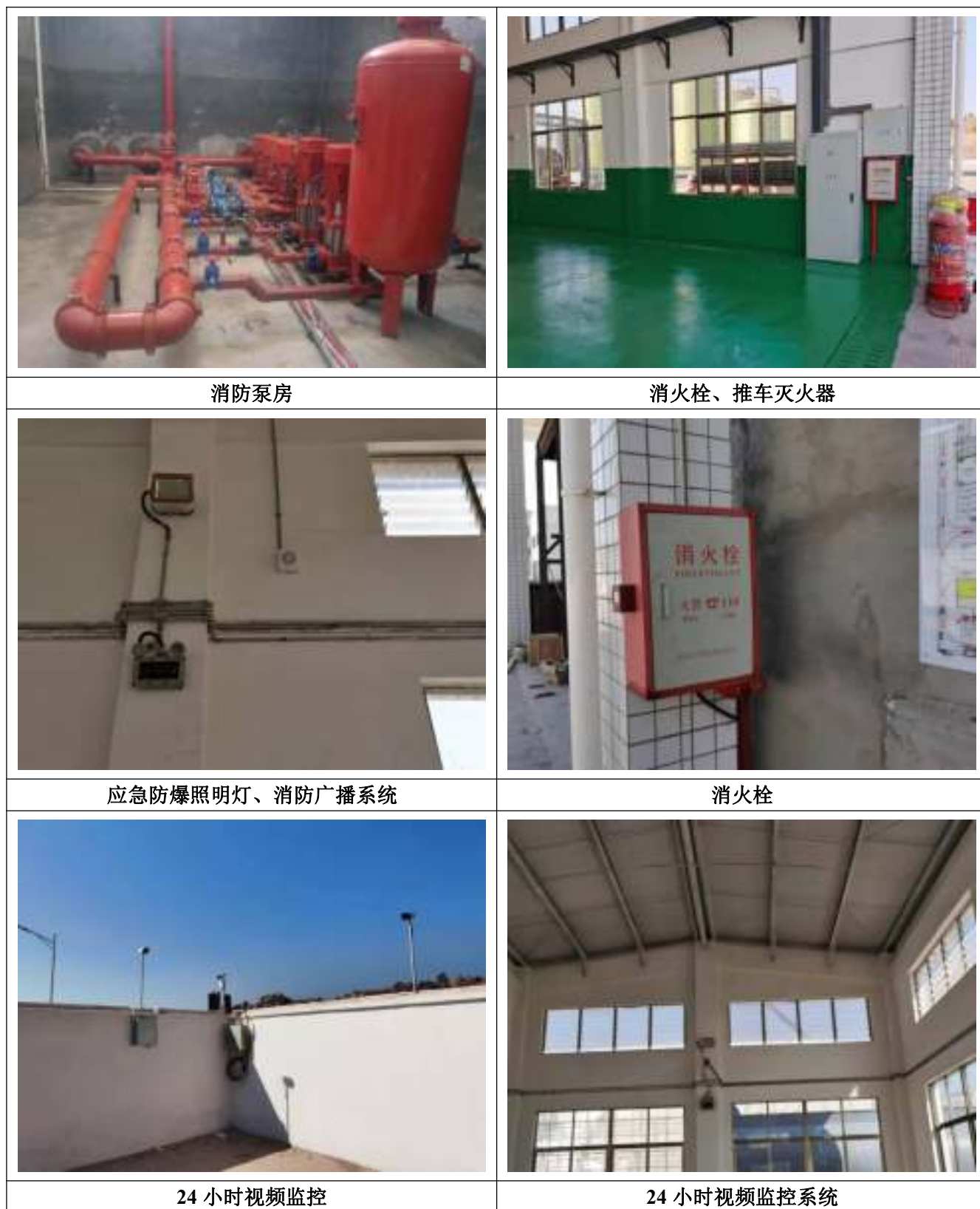
图 2.5-1 企业消防设施实景图
