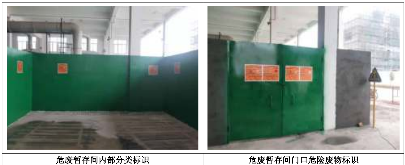
图 2.6-6 危废暂存间相关风险防控措施
