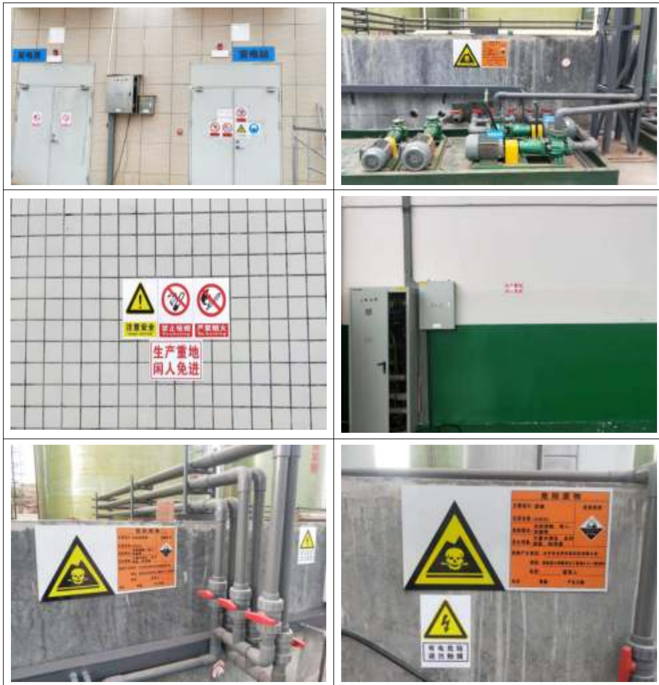
图 2.7-2 应急标识系统实景图
