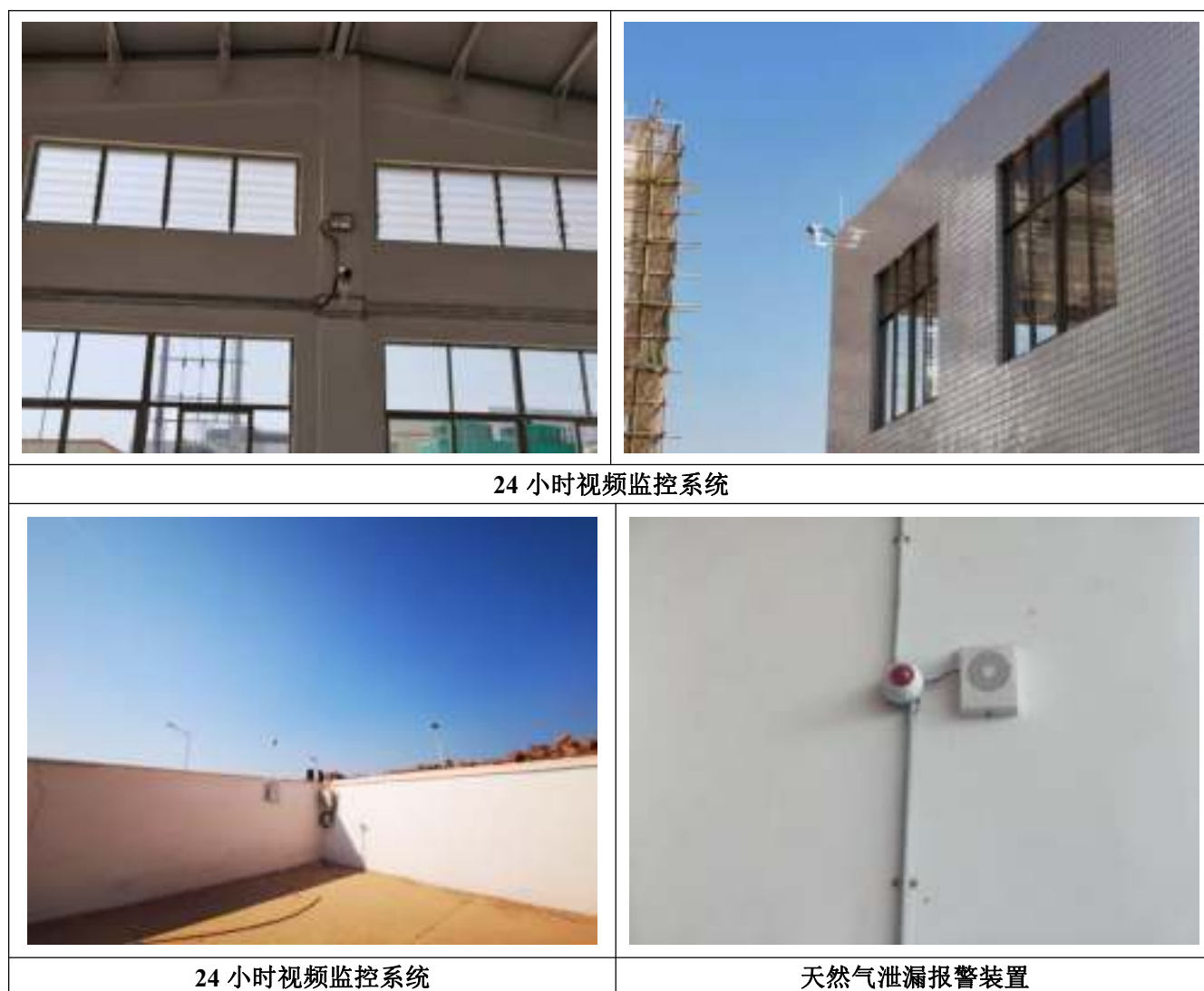
图 2.6-10 监控预警系统实景图
