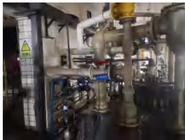
1#反应釜废气收集系统
