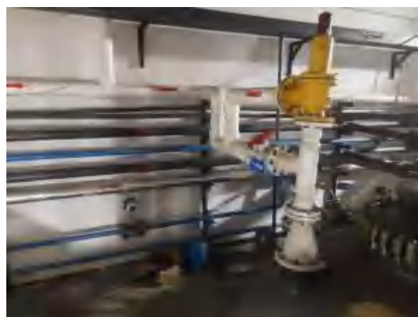
3#反应釜废气收集系统
