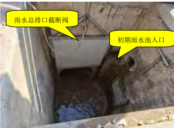
厂区雨水总排口截断阀
