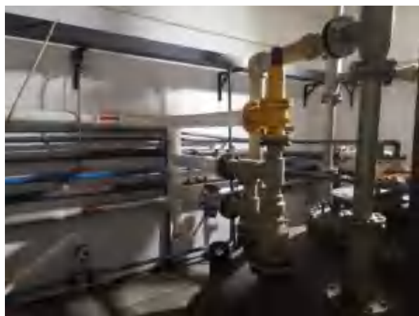
4#反应釜废气收集系统
