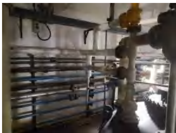
2#反应釜废气收集系统
