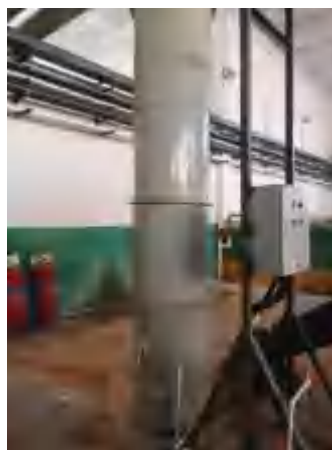
1#反应池废气收集系统
